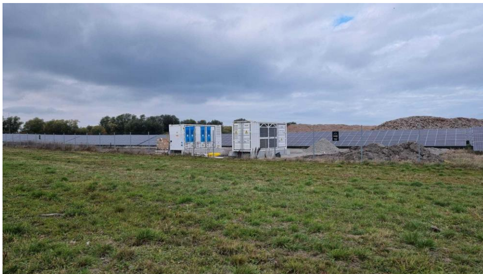
Figur 18. Exempel på batterirack från en annan av Soltechs projekteringar. Effekt 2 MWp.
