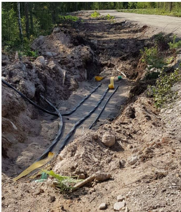
Figur 17. Exempel på en kabelgrav med två 30 kV kablar och rör för optokabel. På bilden ses även ledningsbädd och varningsband/skyddsmarkering.
