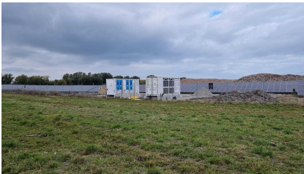
Figur 19: Exempel på ESS i form av batterirack från en annan av Soltechs batteriprojekteringar. Effekt 4 MW.
