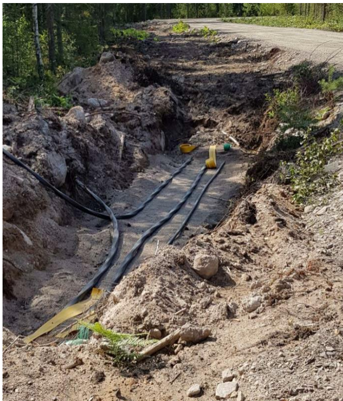
Figur 18: Exempel på en kabelgrav med två 30 kV kablar och rör för optokabel. På bilden ses även ledningsbädd och varningsband/skyddsmarkering.
