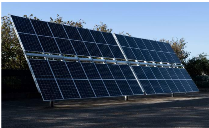
Figur 12: Exempel på ett tracker system från Convert Italia.
