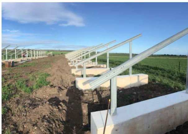
Figur 13. Exempel på ett fast system med fristående markförankring från Schletter
