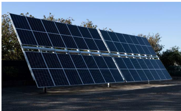
Figur 11. Exempel på ett tracker system från Convert Italia.
