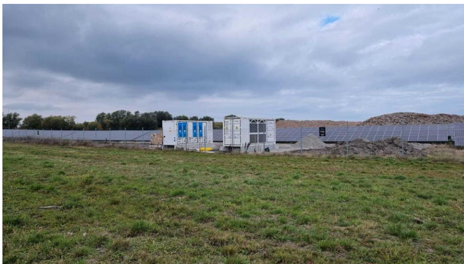
Figur 18. Exempel på batterirack från en annan av Soltechs batteriprojekteringar. Effekt 2 MW.
