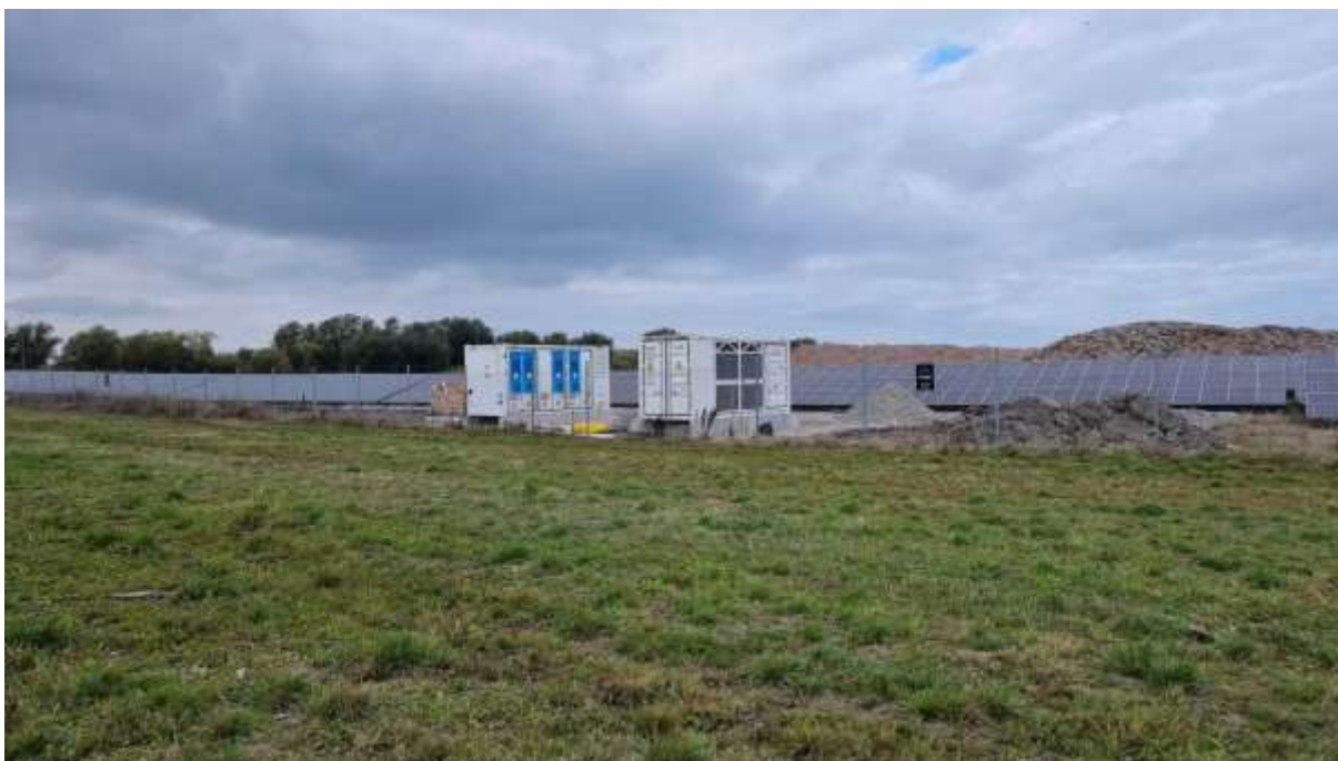
Figur 13. Exempel på rack från en annan av Soltechs projekteringar. Effekt 2 MW.
