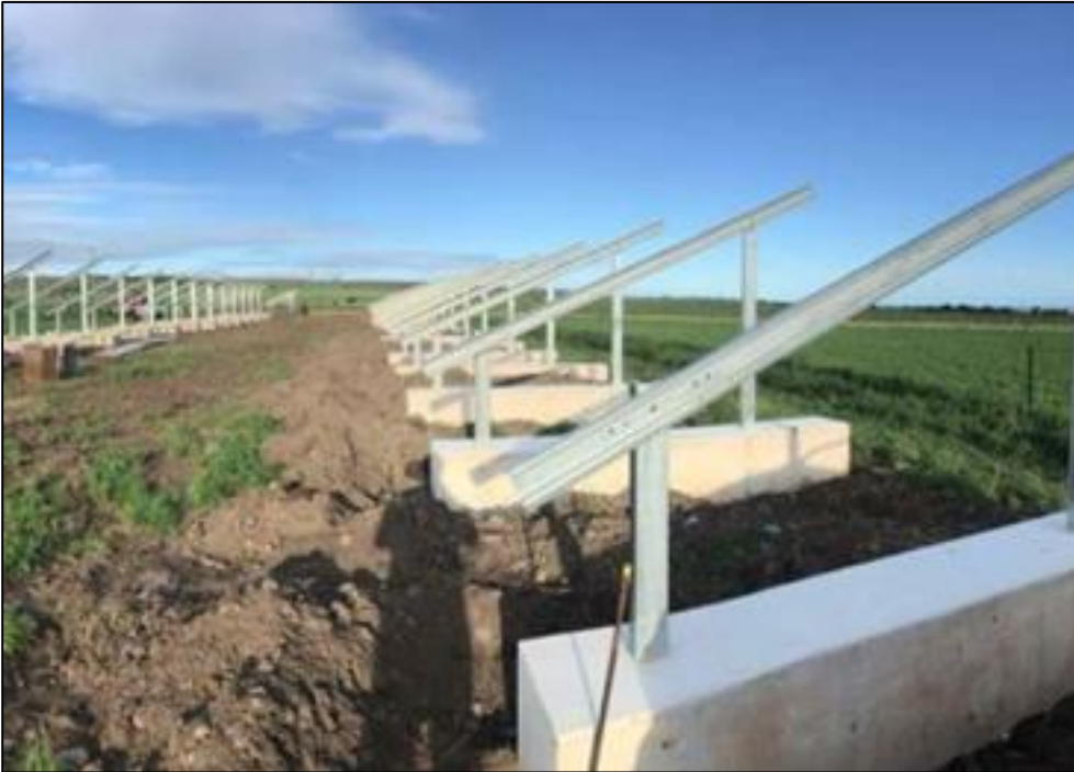
Figur 18. Exempel på ett fast system med fristående markförankring från Schletter.
