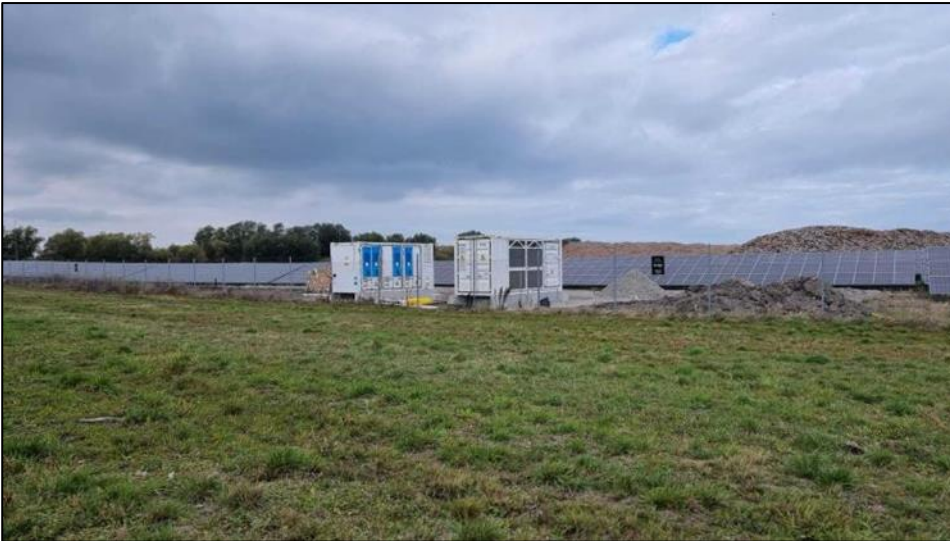
Figur 23. Exempel på batterirack från en annan av Soltechs projekteringar. Effekt 2 MWp.
