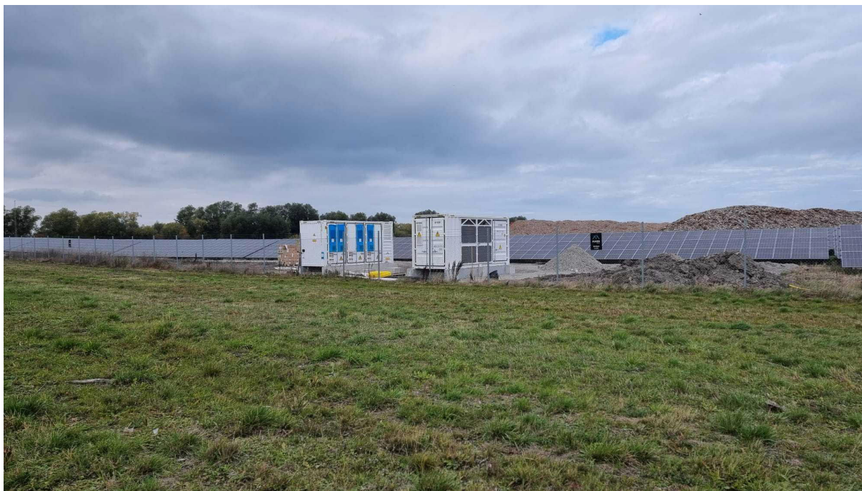
Figur 11. Exempel på batterirack från en annan av Soltechs batteriprojekteringar.
